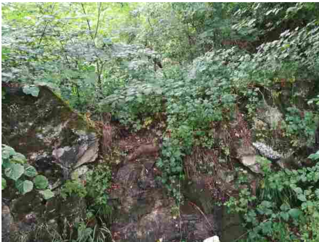
FOTOGRAFIA 7 USZKODZENIA KORPUSU ZAPORY.
